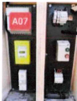
Image 1 : armoire A07 à rénover
