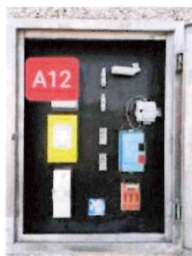
Image 2 : armoire A12 à rénover
